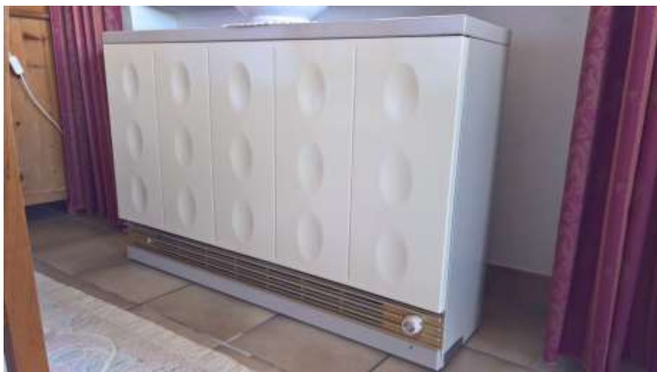
Nachtspeicherheizung Foto: Bernhard André
