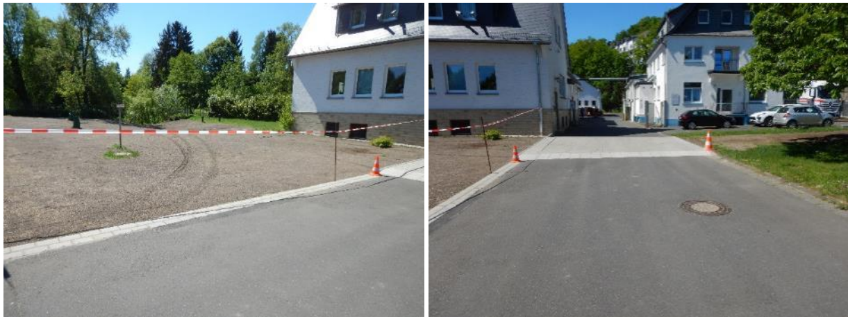
Abb. 5-40: Hochwasserschutz Duroplast, örtlicher Eindruck
