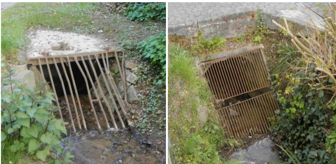
Abb. 5-14: Ungünstiger Einlauf einer Verrohrung
